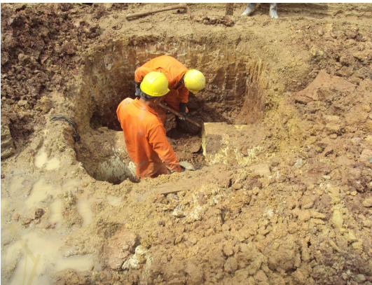
Construcción de pozos sin el aval de la EAAB
